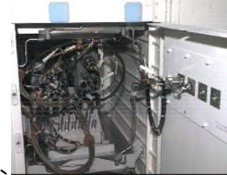
A MAGR installed in Av Bay 3B
